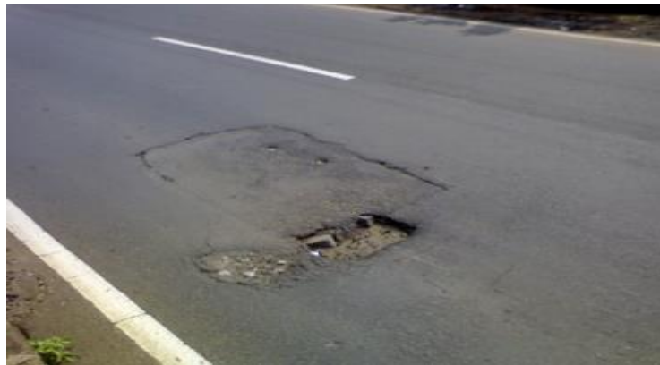
Gambar 2.5 Kerusakan Lubang dan Tambalan
