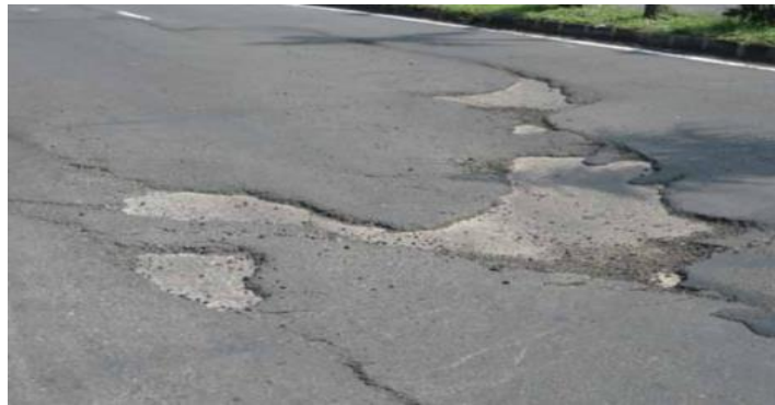
Gambar 2.4 Contoh Kerusakan Tekstur Permukaan (delaminatio)
